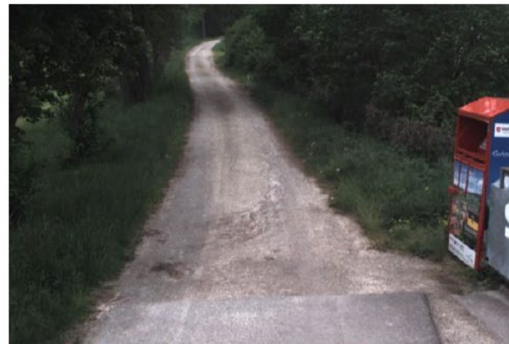
Foto 2: schadhafte Oberfläche (Quelle: Lehmann + Partner)
