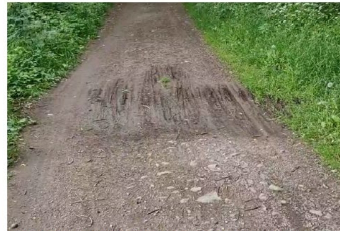
Foto 3: Mangelhafte Entwässerung (Quelle: JAVIDO)
