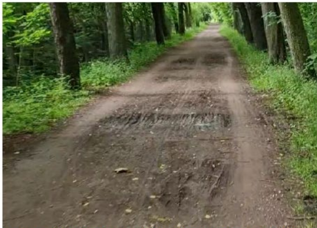
Foto 2: Mangelhafte Entwässerung (Quelle: JAVIDO)
