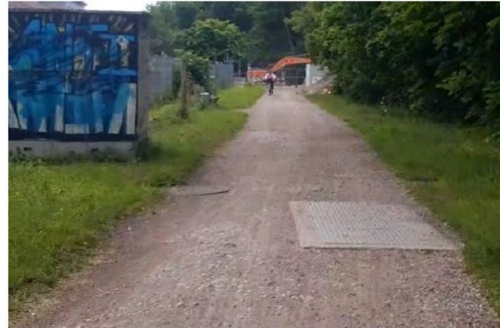
Foto 1: Unebene Oberfläche durch Abflussschächte (Quelle: INVER)
